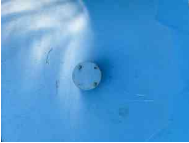
电炉二次废气排气筒采样口（DA061）
