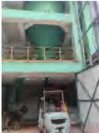
图 3.6-1 电炉除尘灰仓及密闭袋装泄灰
