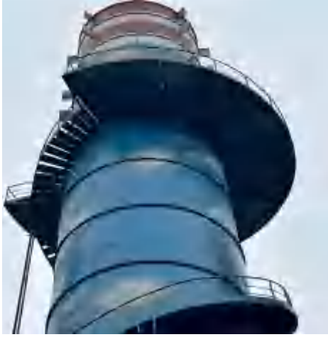
精炼、真空脱气废气采样平台（DA062）
