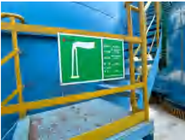
电炉二次废气排气筒标识（DA061）
