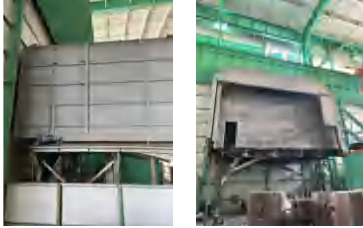
图 3.6-2 模铸除尘罩车及除尘器照片
