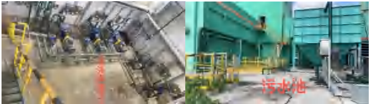
图 4.1-4 厂内污水处理系统照片
