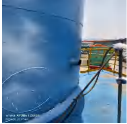
电炉一次废气排气筒采样口（DA060）
