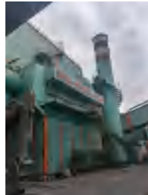
DA058 热闷废气湿式除尘器
