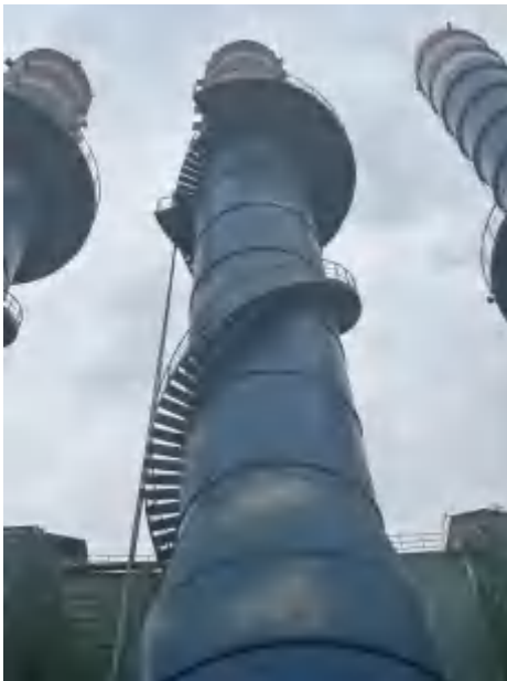
精炼废气、真空脱气废气排气筒（DA062）
