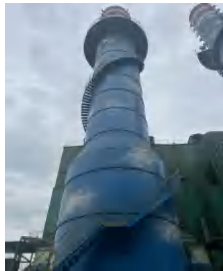
电炉二次废气排气筒（DA061）
