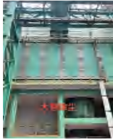
连铸废气、钢包维修废气、火焰切割废 气、上料废气袋式除尘器（DA063）
